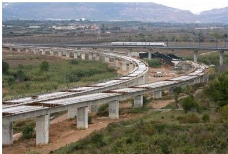
Imagen de archivo de las obras del corredor del Mediterráneo en su enlace con la línea de Alta Velocidad Barcelona-Madrid a su paso por Perafort (Tarragona). EFE/Jaume Sellart
